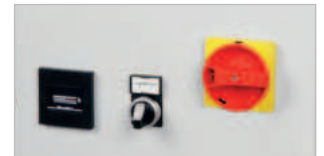
Stern-Dreieck-Schalter mit Betriebsstundenzähler bei AIRPROFI 1253/500/10 H
